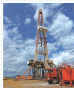
本プロジェクトの対象フィールドであるメネンガイ地域の地熱井掘削リグ
